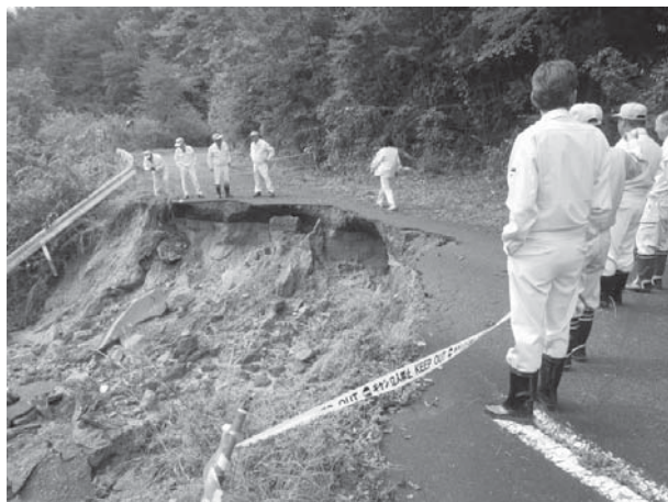
林道大垪線道路崩落
