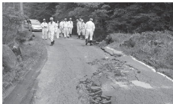
町道桶地線道路陥没
