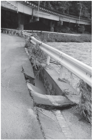
台風15号の大雨で冠水し、破損した夢想橋付近の道路
