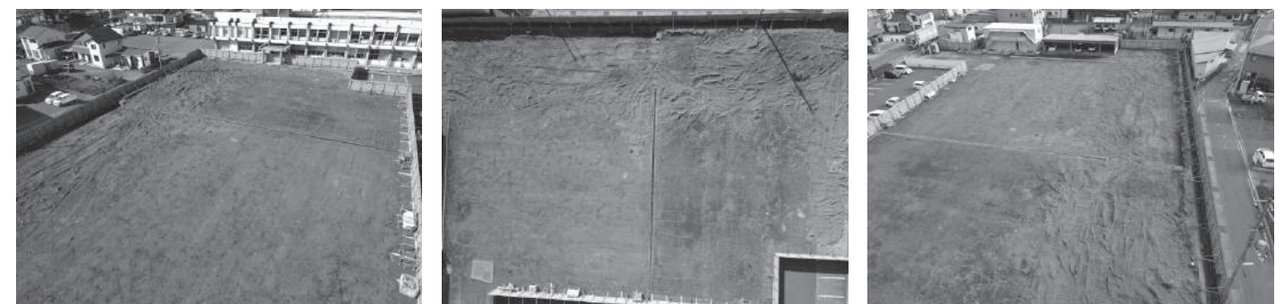
建設予定箇所にあった建物の解体工事が終わり、建築が始まります。
