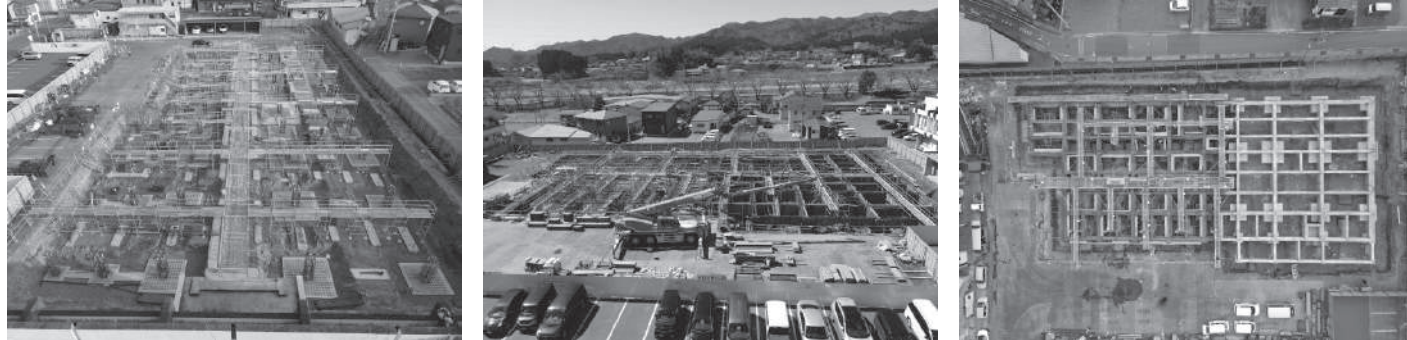
基礎工事のための地足場（鉄筋工事などのため地面レベルに設ける足場のこと）を設置した状況です。地中梁（独立基礎相互間を繋ぐ地中に設ける梁のこと）の基礎配筋、型枠の施工状況です。基礎コンクリート打設が完了して、地足場を撤去した状況です。
