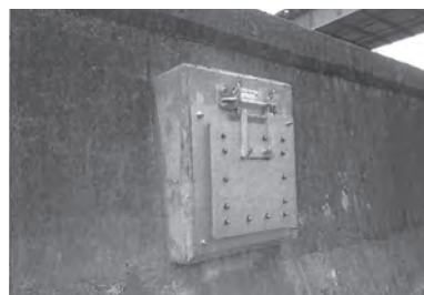
フラップゲートが設置されました
