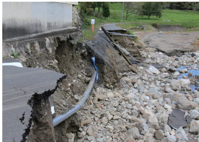
道路の災害（川上地区）
