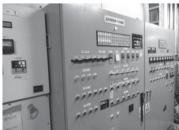
湯遊ランドはなわ温泉設備集中制御盤
