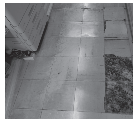
至る所にあるひび割れ
