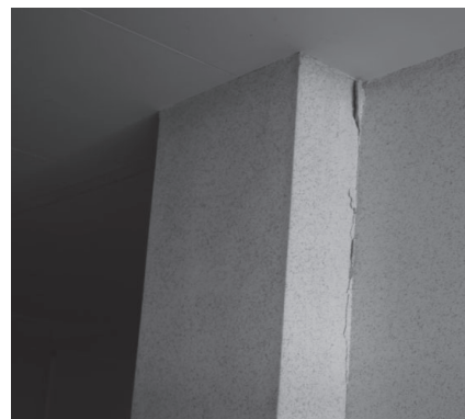
壁が剥がれかけ危険な状態
