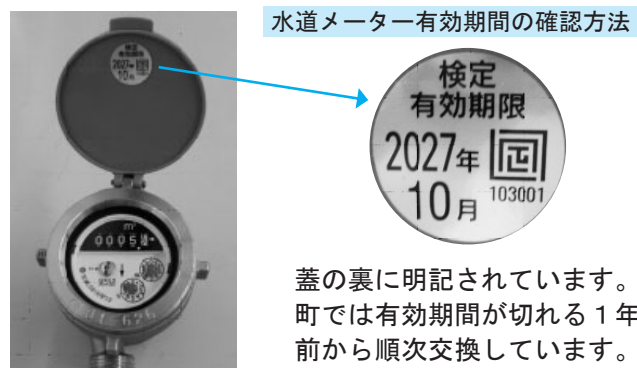
水道メーター有効期間の確認方法
