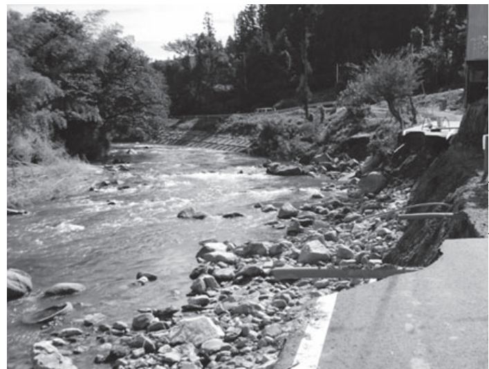
川上薄久保地内の護岸崩落箇所
