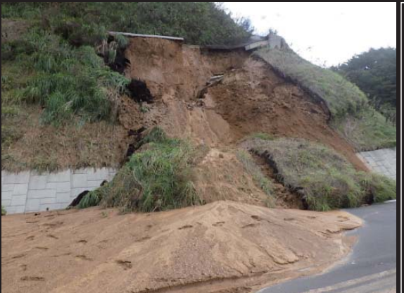
各所で土砂崩れも発生(片貝地内)
