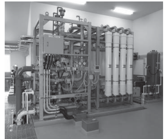
浄水場内のろ過機
