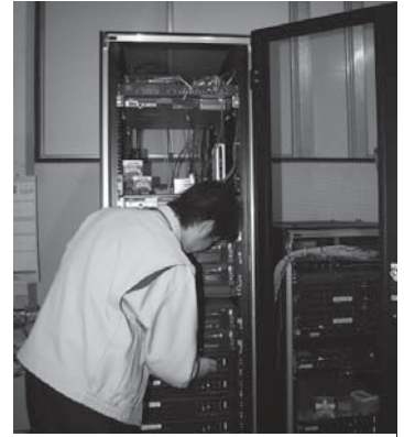
現在は役場庁内にサーバー設置
