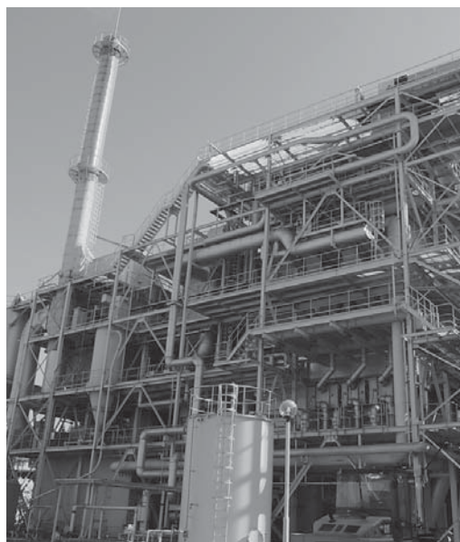
白河市にある木質バイオマス発電施設
