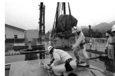
浄化センター設備点検
