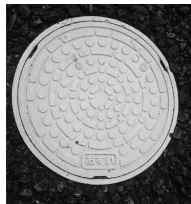
宅内に設置されている「ます」
