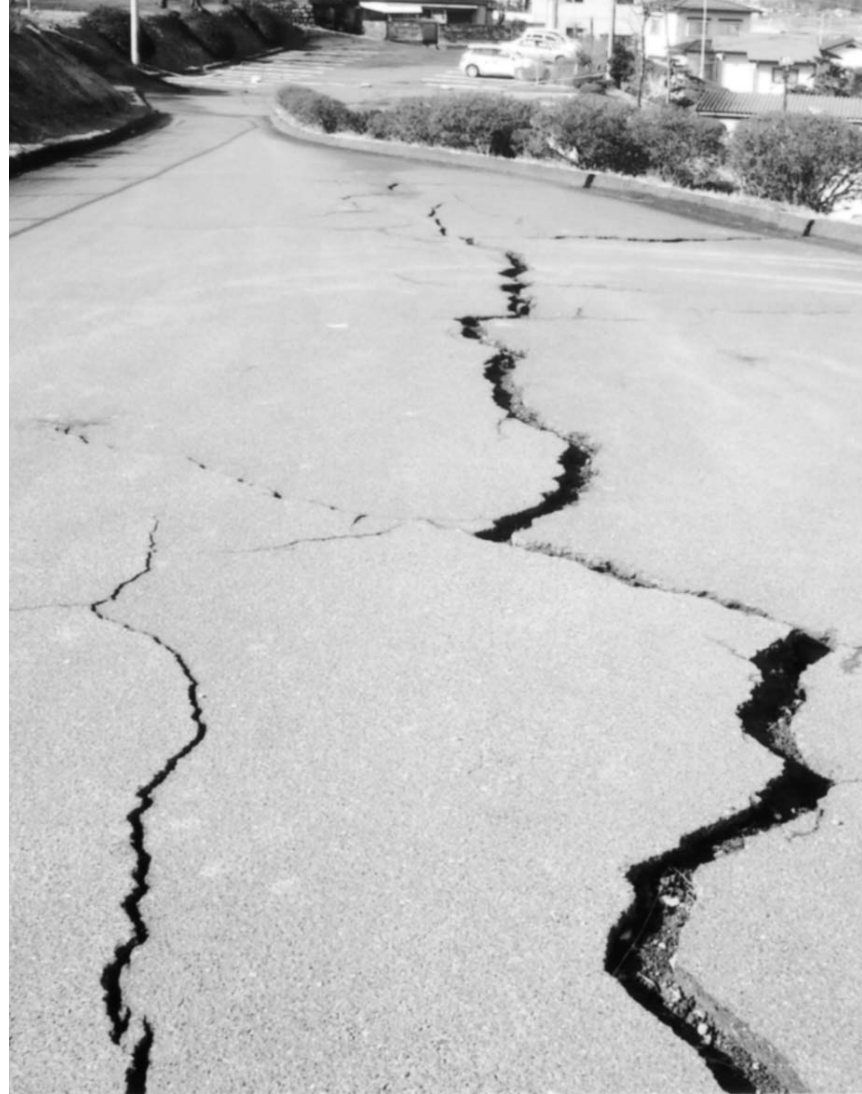
3月11日の地震で入った亀裂(町営グラウンド駐車場周辺)
