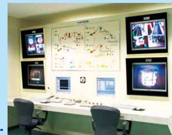
中央監視室 ごみの受入から搬出までをコンピュータで集中管理し、安全かつ効率的に処理します。
