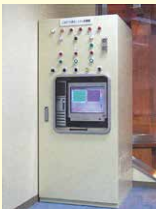
ごみピット消火システム 貯留ピット上部に取り付けられた赤外線カメラにより、常時監視し、火災時には自動消火するシステムです。
