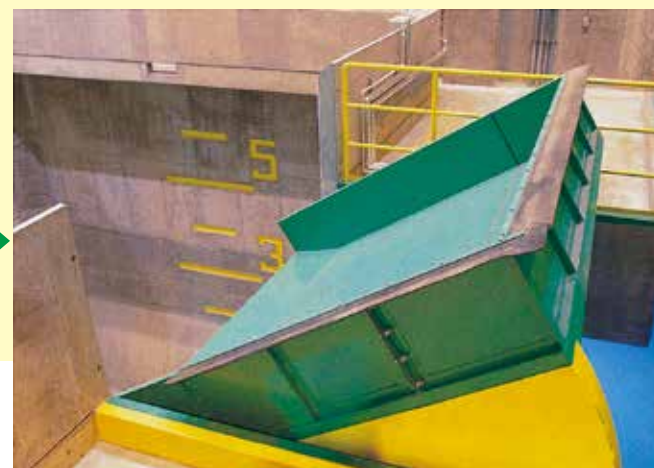
不燃ごみ受入装置 一般持ち込みのごみは安全対策のため、一時不燃ごみ受入装置におろし、ピットへ投入します。
