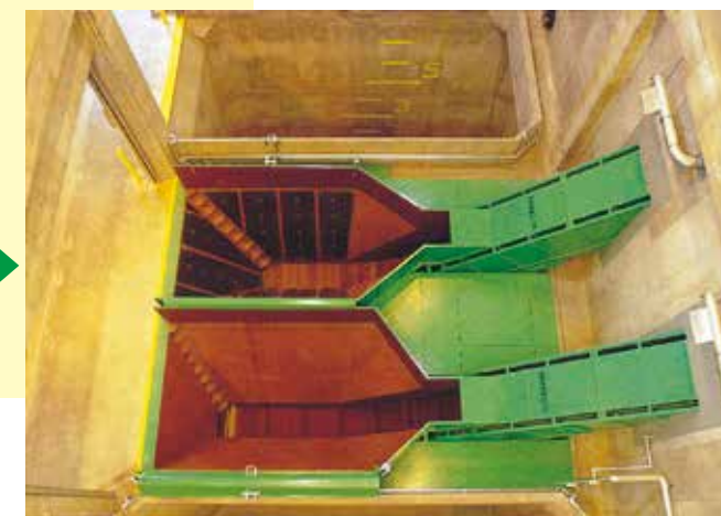
受入ホッパ ごみは、貯留ピット・貯留ヤードからクレーンやホイールローダーで、受入ホッパに投入します。
