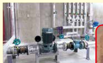
余熱利用 隣接するクリーンセンターで発生する余熱を、リサイクルプラザ内で暖房・温水に利用しています。
