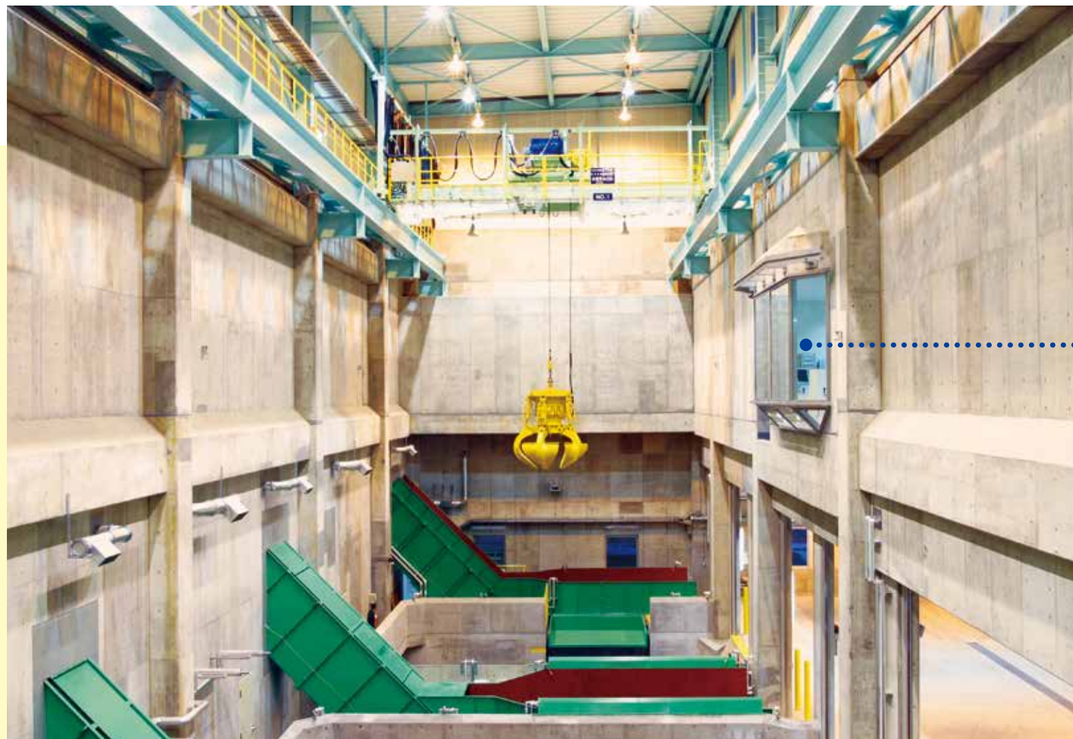
貯留ピット・受入ホッパ・ごみクレーン
