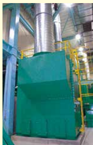
脱臭装置 ごみ等の悪臭を吸収し処理します。
