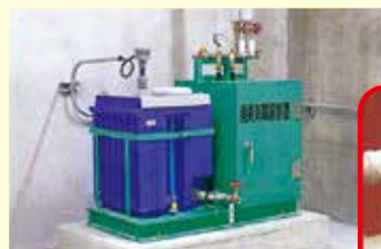
消臭剤噴霧装置 悪臭を消すため、貯留ピットや貯留ヤードに配置しています。
